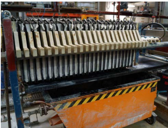
La fotografia mostra una filtropressa per l'asciugatura dei fanghi in un impianto di trattamento delle acque reflue.
