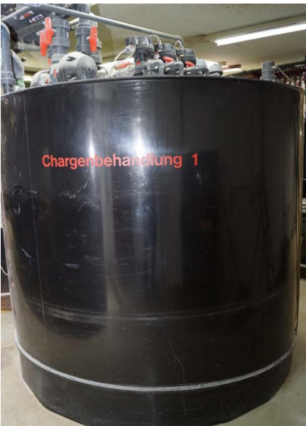
La fotografia mostra un serbatoio di raccolta delle acque reflue.
