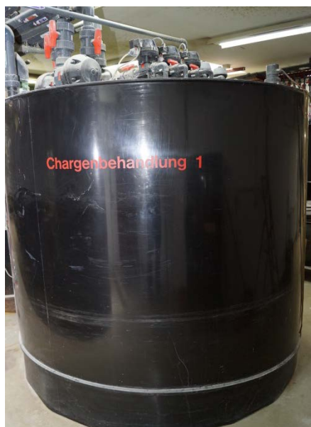
La photo montre un réservoir de rétention des eaux usées.
