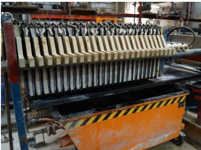
Die Abbildung zeigt eine Filterpresse zur Fest-/Flüssig-Trennung als Bestandteil einer Prozessabwasserbehandlungsanlage
