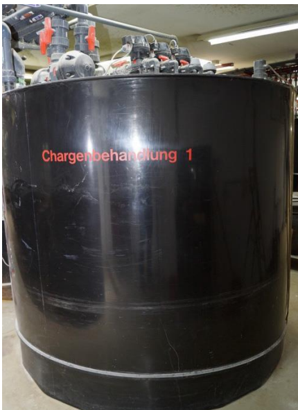
Die Abbildung zeigt einen Abwasserspeichertank.
